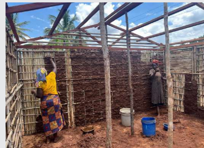
Construcción de refugio resiliente en la comunidad de Mingonha, provincia de Cabo Delgado.
